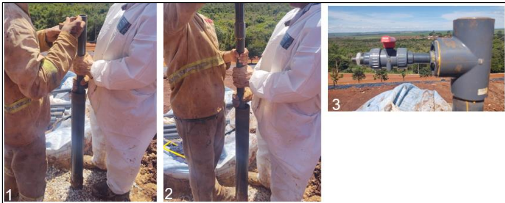
Figura 15 - Etapas de montagem – 1. Cabeçote montado, 2. Válvula esfera com plug metálico utilizado para leitura de gás para o piezômetro protótipo e 3. Apresentação de cabeçote válvula e tubo de ¾ interno que ficará com o sensor de nível Geokon
