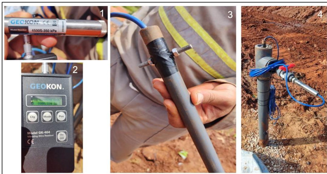
Figura 16 - Etapas de montagem – 1. Sensor elétrico instalado, 2. Medição inicial do sensor, antes da instalação 3. Apresentação de peça adaptada para fixação do tubo do sensor elétrico 4. Piezômetro vector elétrico devidamente finalizado.
