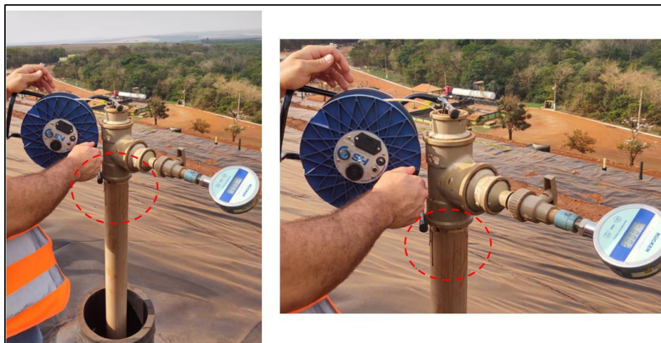
Figura 18 – Piezômetro vector convencional visita técnica realizada em setembro de 2022 (avarias de ressecamento do tubo de PVC)
